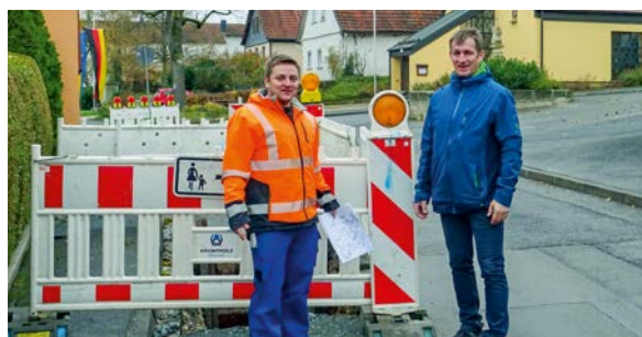
Foto: Heiko Griebel, Stadtwerke Lichtenfels
